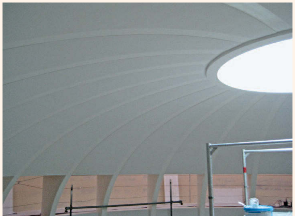
6 Auf die Gipskartonplatten wurden die Putzträgerplatten geklebt und mit dem Akustik-Feinputz verputzt. Die Oberfläche des Akustiksystems ist sehr glatt und wirkt edel. Die offene porige Struktur des Akustikputzes ist nicht sichtbar.
