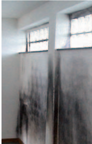
Schränke an kühlen Außenwandflächen wirken wie eine Innendämmung und sind häufig Ursache eines starken, aber versteckten Schimmelbefalls.
